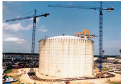
Bonny LNG storage tank
